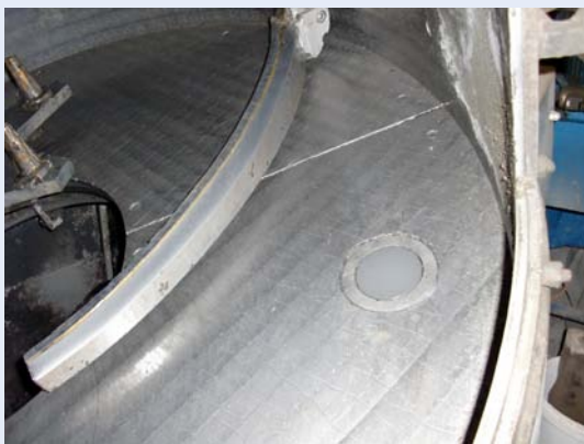
Sondeneinbau im Boden eines Mixers mit drehendem Trog
